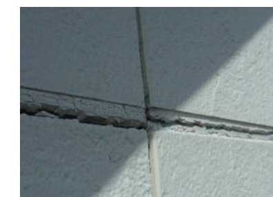
縦の目地より横に入っている目地が切れると、雨漏りに直結するので早めのチェックが必要。
