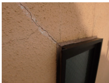
ヒビは窓開口部から入る。防水テープの貼りが悪いと雨漏りに繋がる。
