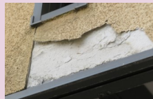
仕上材のめくれの様子
