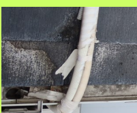
ドレン管の排水が屋根を濡らしています。
