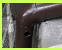
雨樋に空いた穴。ドレン管が抜け落ちています。
